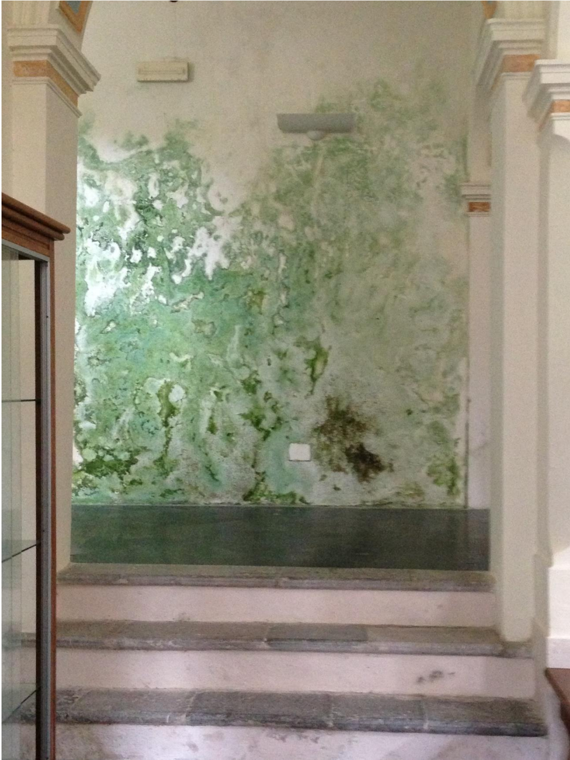
Fig. 5 – Chiesa di Costantinopoli: parete ammuffita, lato sinistro ingresso.
