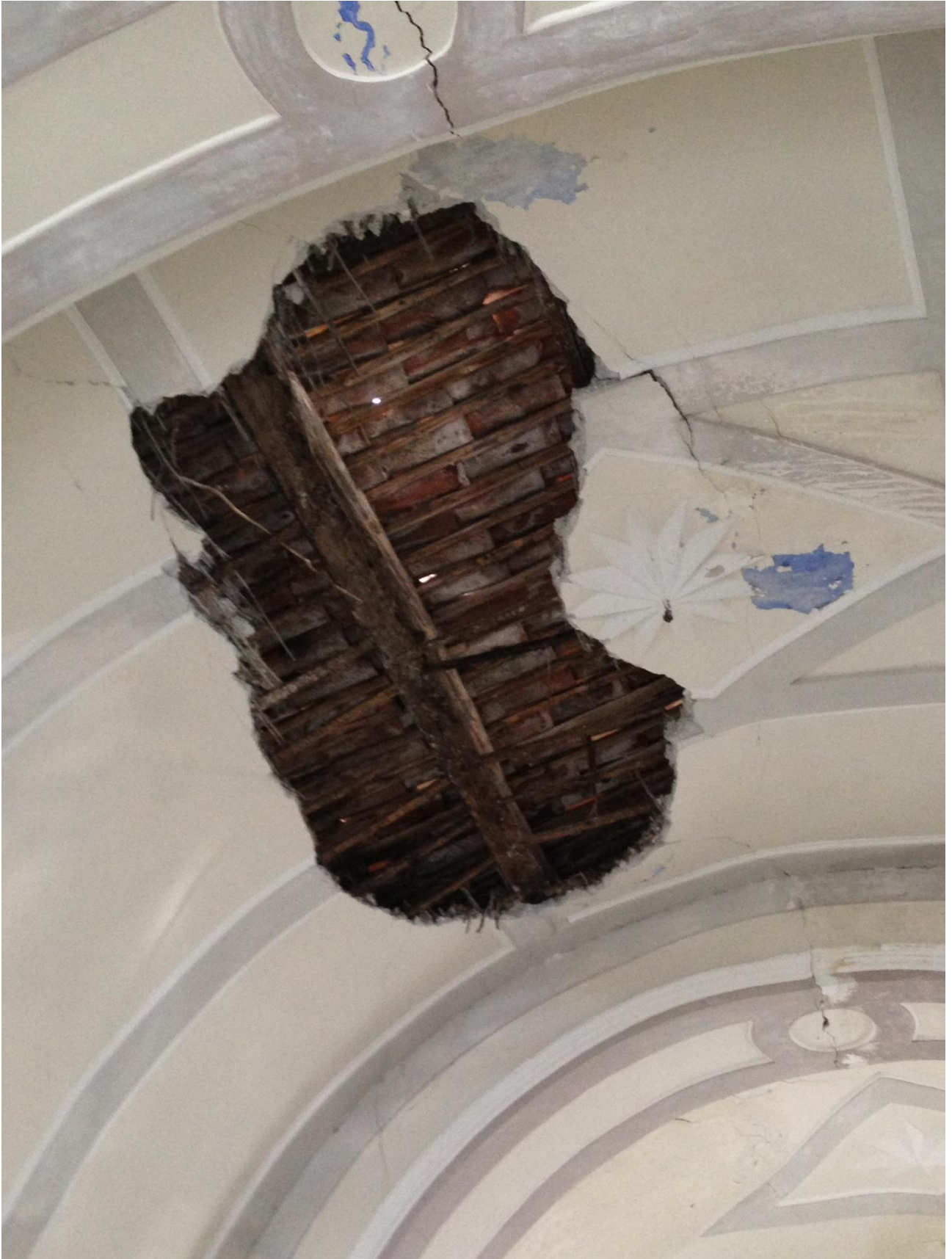
Fig. 20 – Chiesa della SS. Trinità di Avena: particolare del tetto sfondato.
