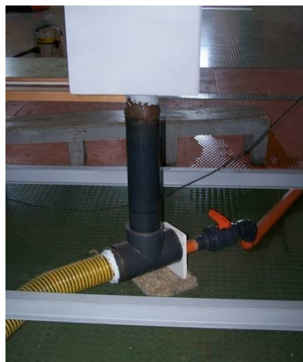
Figura 36 – Tubazione di uscita dal cassone di valle
