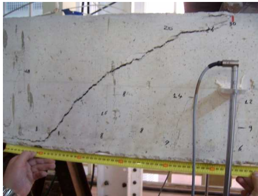
Figura 4.111: Trave A.02 a rottura
