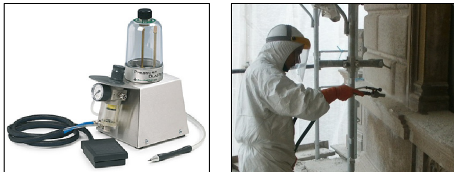
Figure 5.2. Apparato strumentale di Microsabbatura (a sinistra) e Pulitura della facciata del Duomo di Milano mediante micro-sabbatura (a destra).
