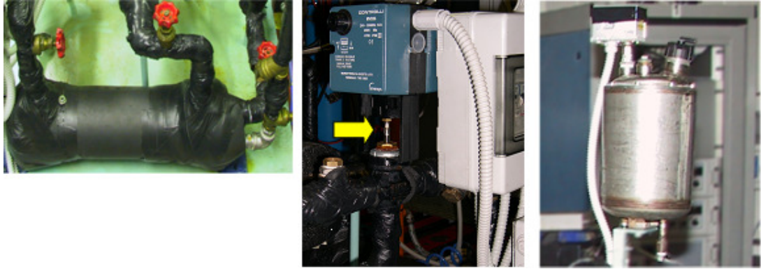
Fig. II.1.5.2 – Scambiatore, valvola motorizzata e serbatoio di espansione
