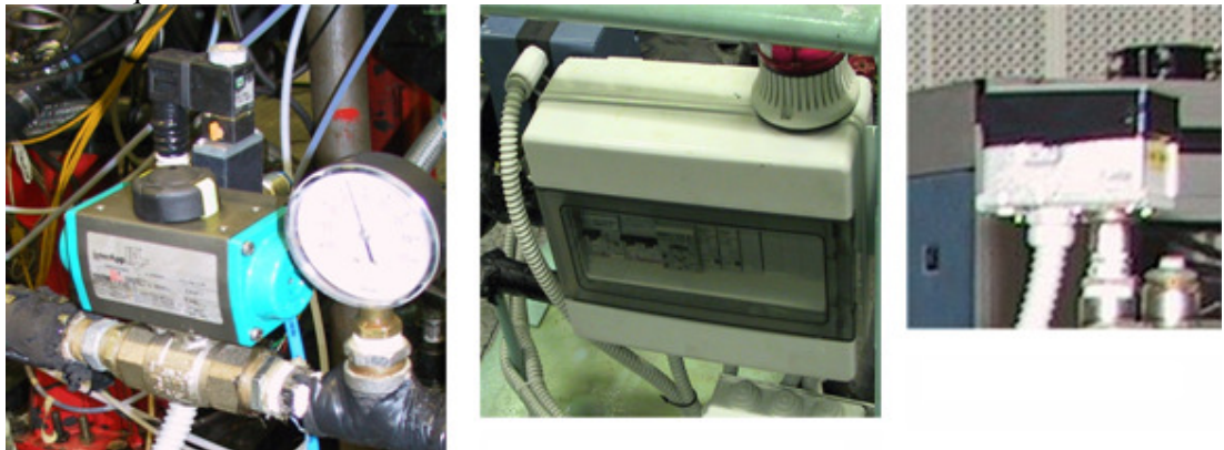
Fig. II.1.5.3 Valvole, pannello elettrico e pressostato
