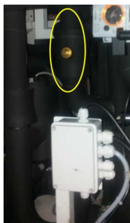
Figura 6.72 – Bypass installato sul ramo di bassa pressione.
