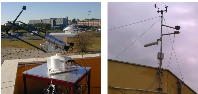
Figura 5.6 - Stazione di acquisizione dati solari e stazione meteo (Urtin-Pci).
