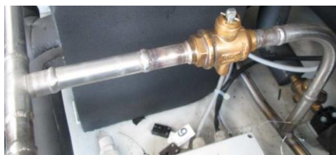
Figura 6.42 – Bypass installato sul ramo di bassa pressione.
