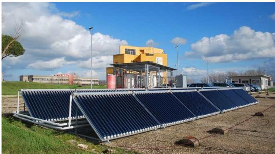
Figura 5.1 - Impianto di solar heating and cooling installato presso il C.R. Enea di Casaccia (Roma).
