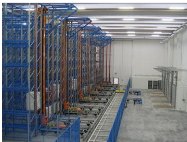
Figura 2.22 Magazzini automatici serviti da traslo elevatore (Foto Cassioli srl)
